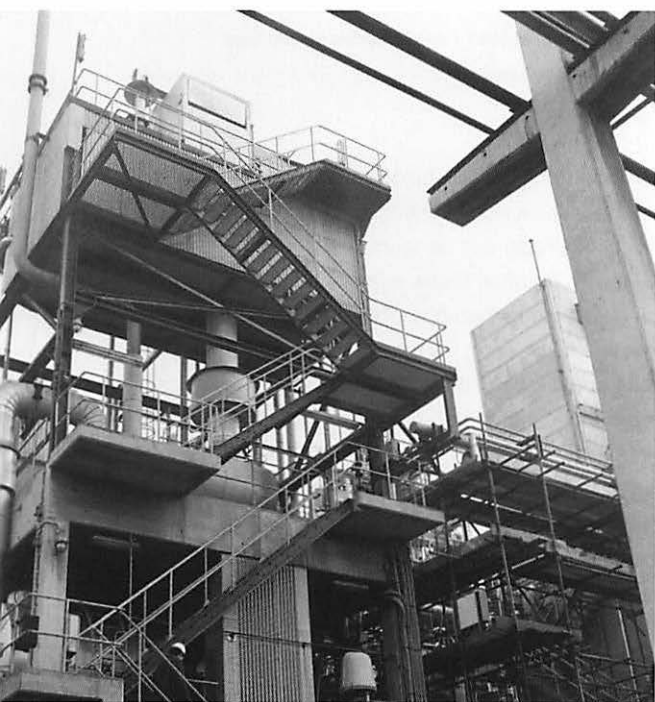
Na toestemming van de minister van Economische Zaken in 1963, kon worden begonnen met de bouw van de lysinefabriek. Hier een onderdeel daarvan: de zwaveltrioxide-installatie.
